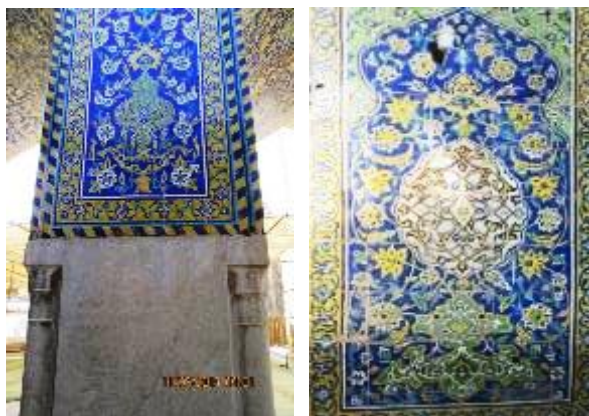
شکل ۵: تصویر سمت راست کاشیکاری معرق مدرسه جده بزرگ، تصویر سمت چپ کاشیکاری معرق مدرسه سلیمانیه (ماخذ نگارندگان)
